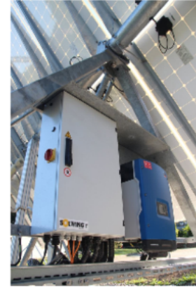
Spindelhubantrieb und Wechselrichter 5kW
